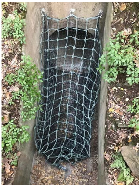
Illustration 23 : Filets sur exutoires pluviaux (Crédit : Pollustock)
